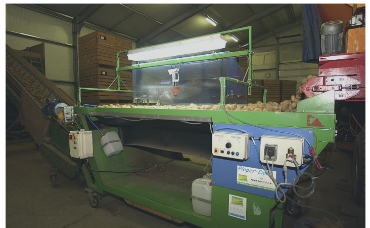
Bij schoonspuiten van de pootgoed-douche komt waswater met gewasbeschermingsmiddel vrij. Verwerk het waswater daarom met een biofilter, Phytobac of Heliosec.
